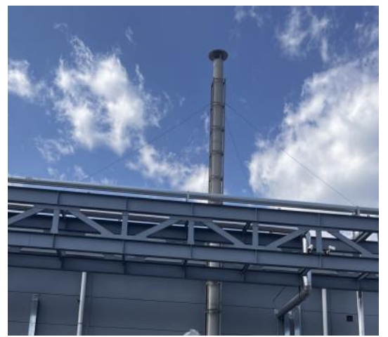
车间有机废气排放口
