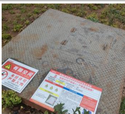
厂区现有的化粪池之一
