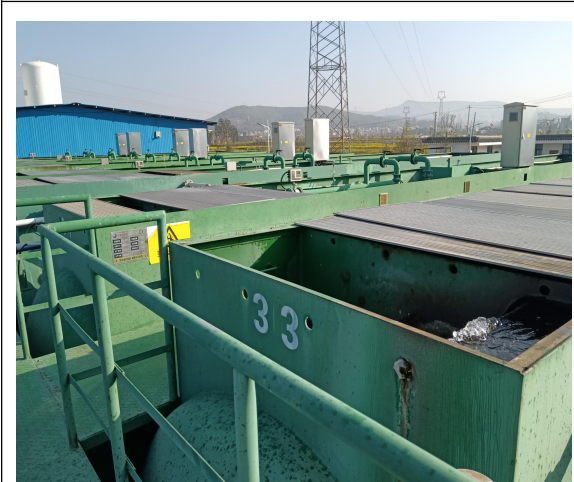
产业园区的临时污水处理厂
