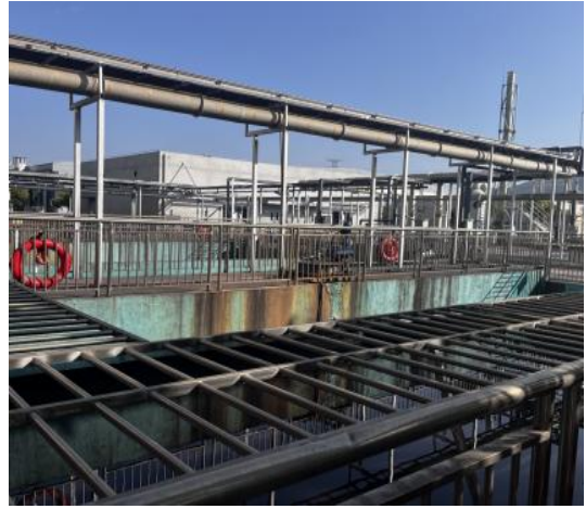
厂区现有三期污水处理站
