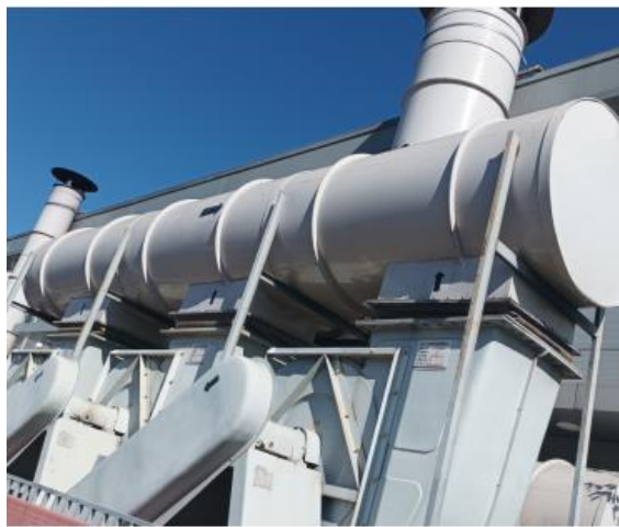
车间的通风换气口
