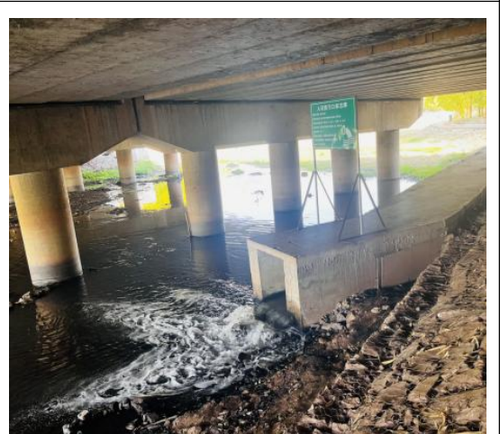
临时污水处理厂的排污口
