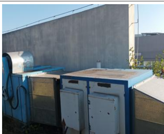
食堂顶上的油烟净化设备
